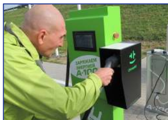
Электрические зарядные станции
